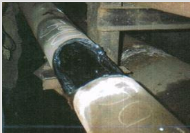
Смотровое отверстие непосредственно за насосом
