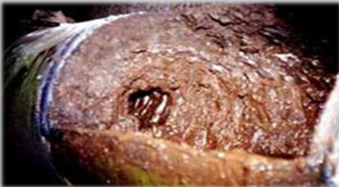
Zanieczyszczona rura w 90 % przekroju.
