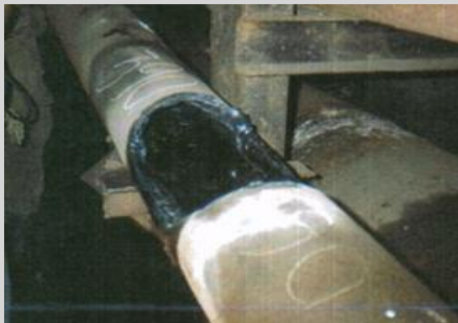
Otwór rewizyjny bezpośrednio za pompą
