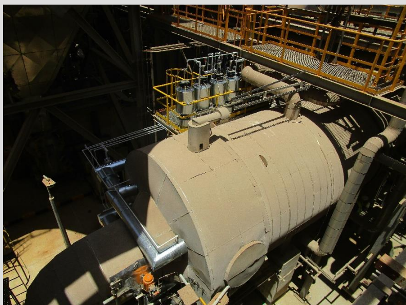
Instalacja czyszczenia drugiego biegu WHB (weast heating exchanger) – TASNEE Arabia Saudyjska
