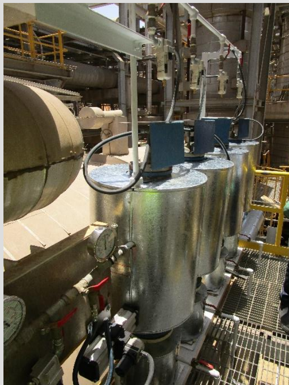
Generatory fal uderzeniowych GFU 24/8 zabudowane w TASNEE Arabia Saudyjska
