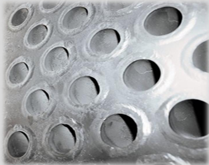
Płomieniówki z instalacją GFU-24/8
